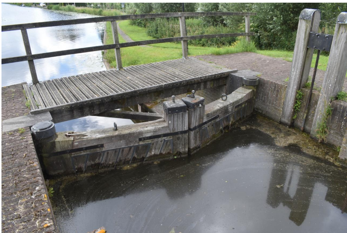
Figuur 15. Benedenhoofd gefotografeerd vanuit het noorden met links de puntdeuren met het bruggetje op de achtergrond en rechts het bewegingsmechanisme van het omloopriool (foto's: RAAP).
