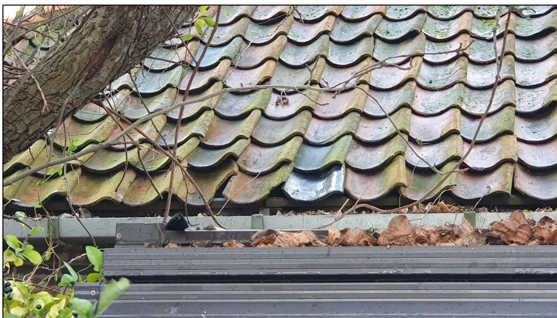
Figuur 10: Losse of scheefliggende dakpannen bieden potentiële nestlocaties voor de huismus.
